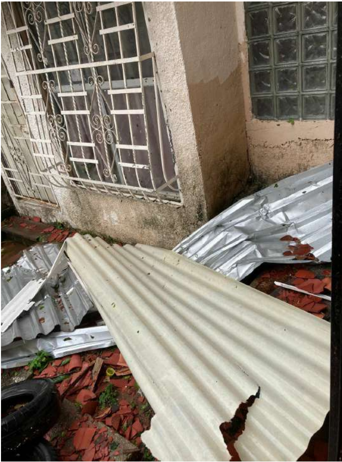
Figura 3. Accesos a casa habitación obstruidos por láminas y escombros. Fuente: Tomada por Esmeralda Vilchis.
