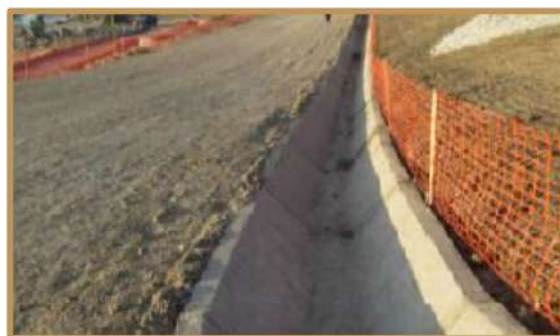
Figura 29. Canales para agua pluvial. Fuente: Sistemas de Ingeniería y Control Ambiental.
